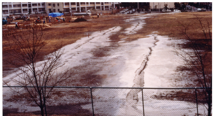
写真：阪神・淡路大震災の液状化現象で流れ出した噴砂
