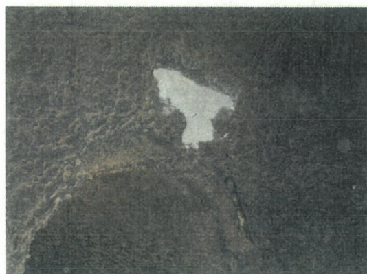
図 1.4 応急補修後の写真
