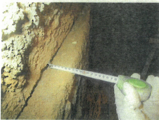
(3) 後燃焼室上部耐火物浮き上がり (補修前)
