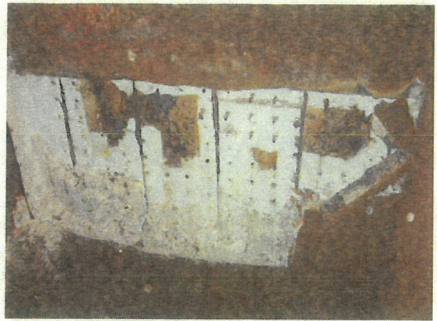
立ち下げ後に脱落した箇所（東面）
