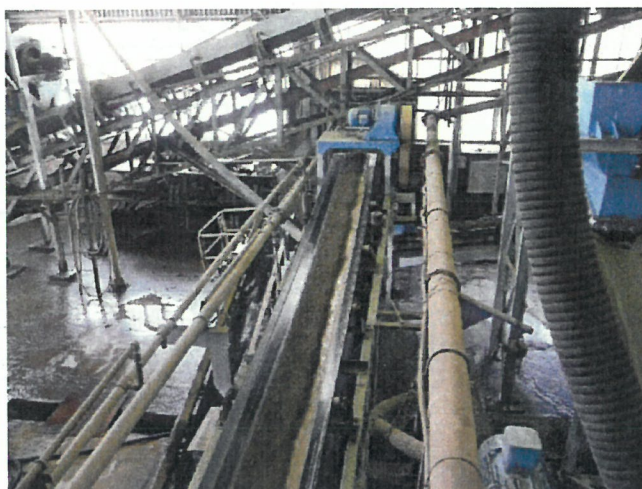
(搬送コンベア)
