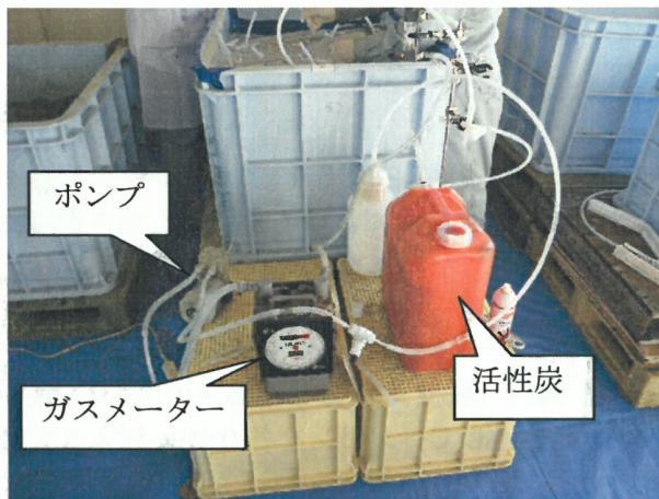
写真1 VOC除去確認試験施設
