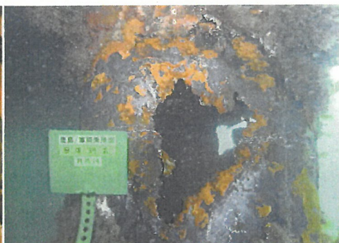
破口したスロープ部の鋼管杭
