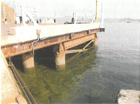
鋼材類の腐食状況
