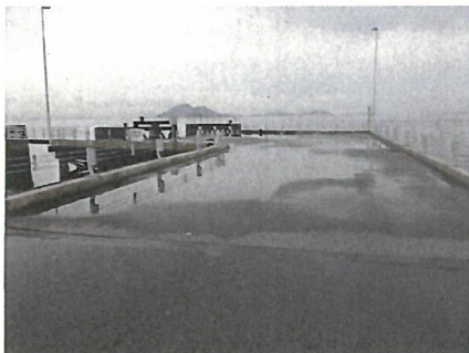
施工前(水溜り発生状況)
