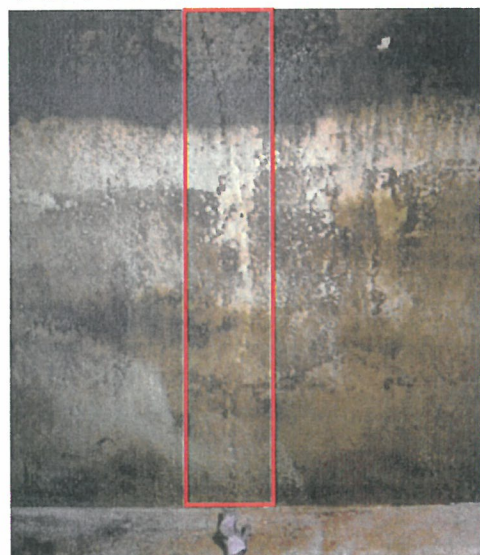
写真2 コンクリートのひび割れに沿った塗装の浮き（第5槽）
