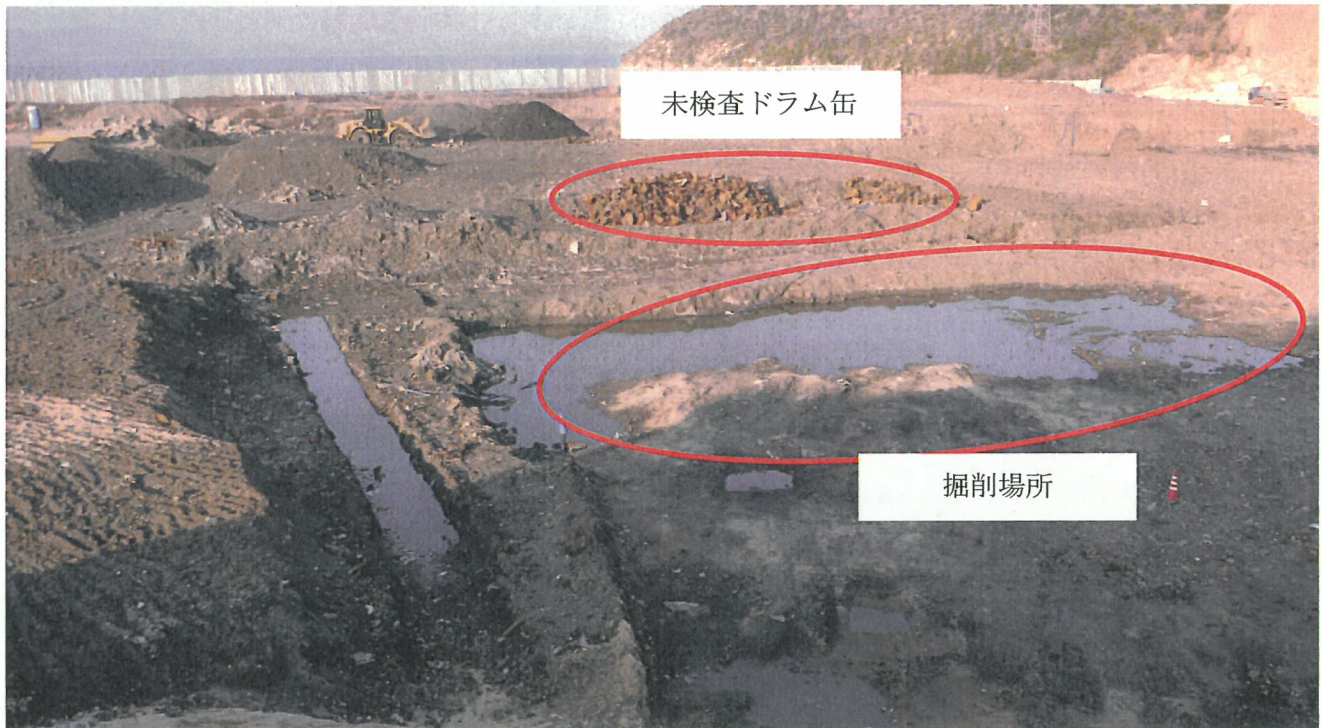
写真4 平成25年1月8日の状況
