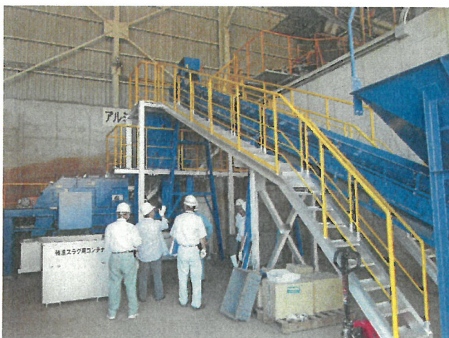
写真 1 試運転中の状況
