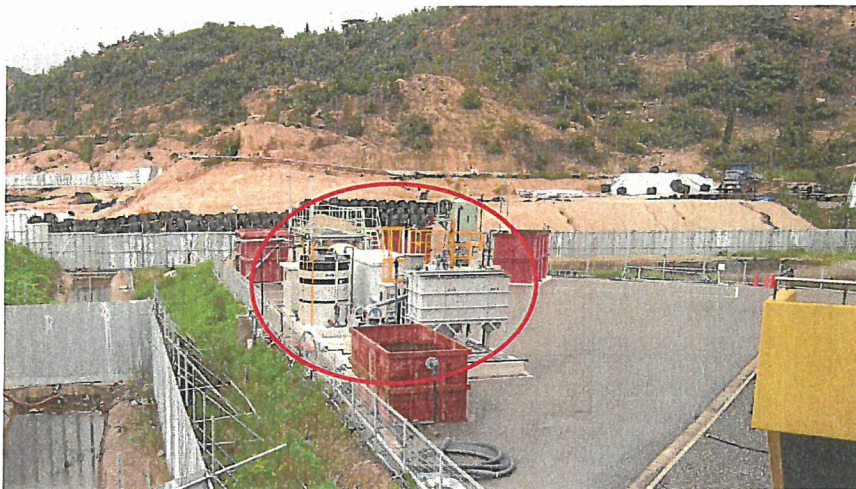
油水分離装置の設置場所 (高度排水処理施設の隣)
