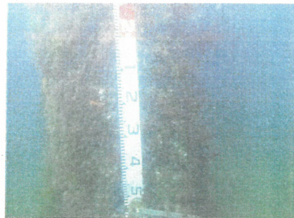
② 鋼材の表面状態 (桁受・下端-2m~-2.5m)
