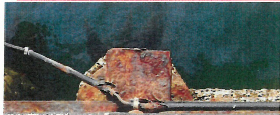
③ 電線管の損傷
