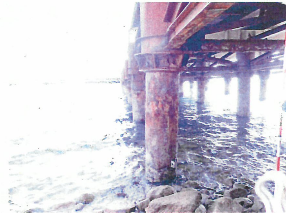
⑤ 鋼管杭の外観 (変位) 状況
