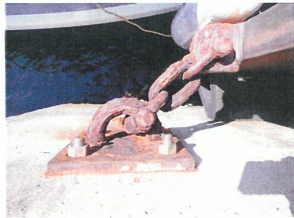
② 防舷材取付け用金具 (リング及びシャックル) の腐食
