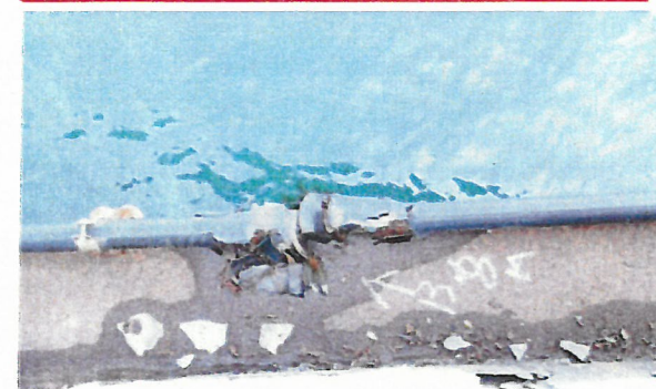
⑦ 電線管の損傷
