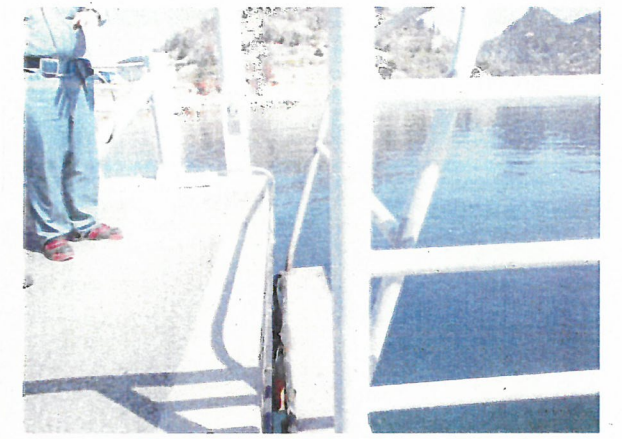
⑥ 防護柵の傾き
