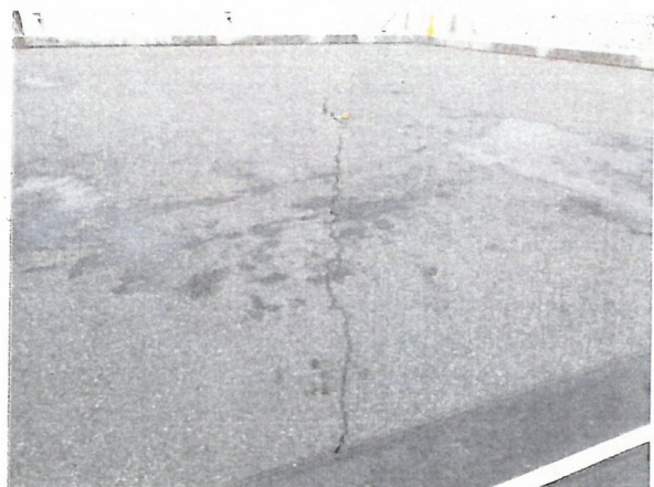
① アスファルト舗装のひび割れ
