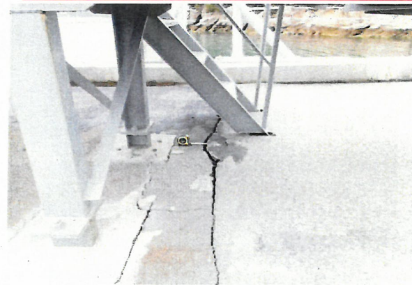
④ アスファルト舗装の開き
