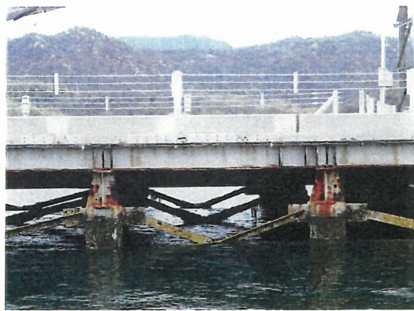
① 表面仕上げモルタルの剥離
