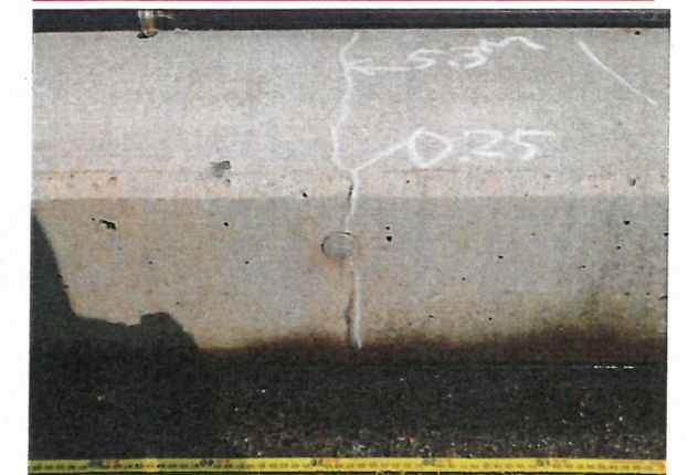
⑧ ガードロープ基礎にひび割れ
