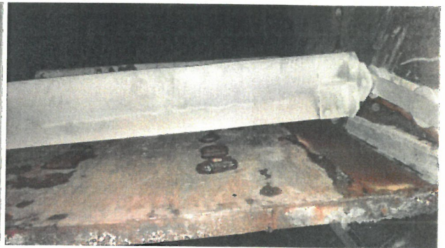
(4) ライナー脱落後のスラグコンベヤ （傾斜ストレート部）
