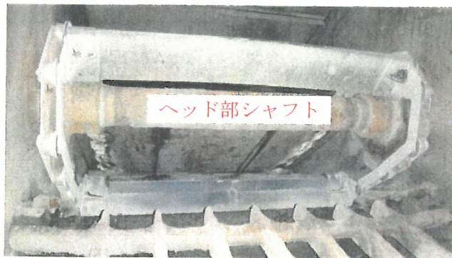
(3) ライナー脱落後のスラグコンベヤ （ヘッドシャフト部）
