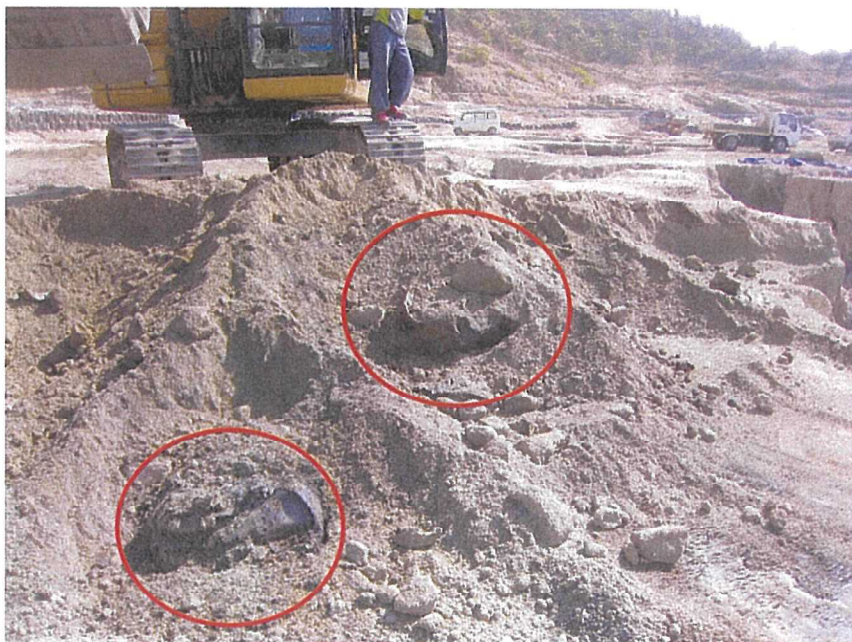
写真1 過去に完了確認後に見つかったドラム缶の埋設状況 ：汚染土壌を50cm掘削中にドラム缶が出現（H27.3.30撮影）
