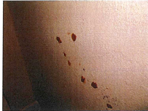
写真8 水槽上部 錆発生部
