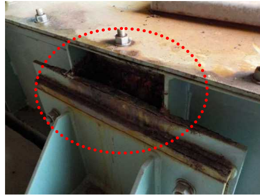
写真8. ホッパーサポート部（発錆）
