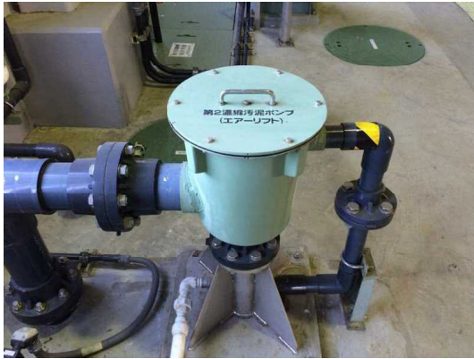
写真 6. 第2濃縮汚泥引抜ポンプ
