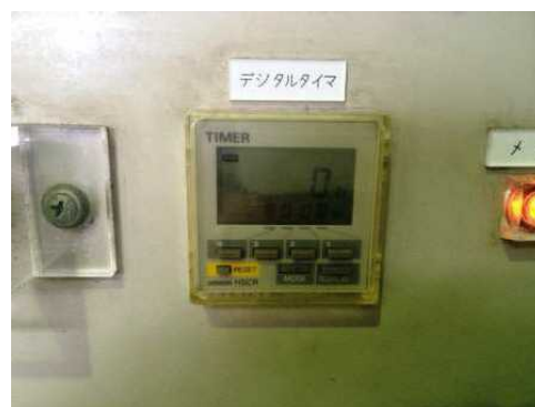
写真 3. 積算タイマー（交換予定）
