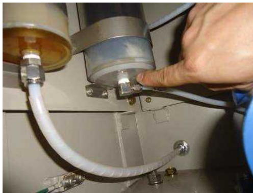
写真 4. 排ガス処理筒（交換予定）
