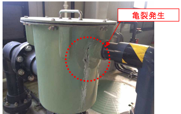
写真 7. セパレートボックス（交換予定）
