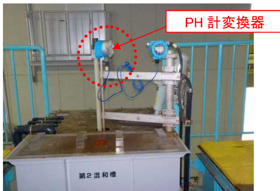
写真 6. 計装機器変換器
