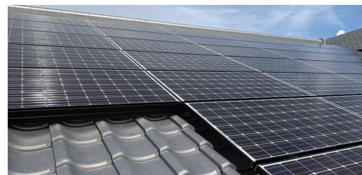
▲住宅用太陽光発電システム
