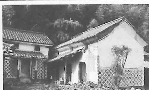
写真3 壊された納屋(平成14年3月撮影)
