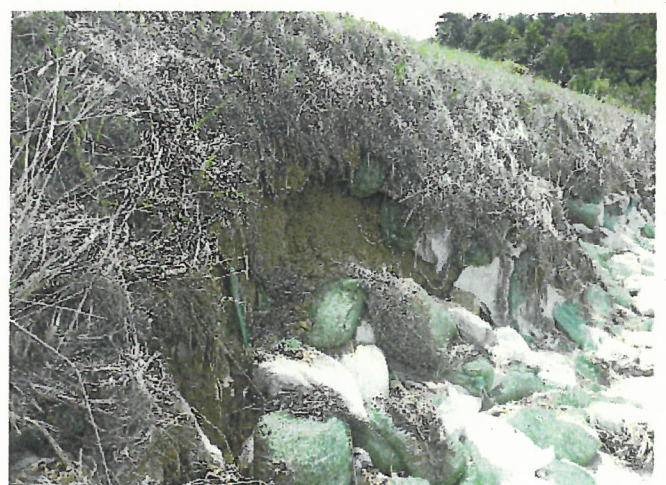
写真2 D測線付近被災状況
