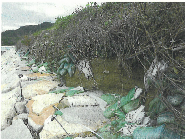
写真1 C測線付近被災状況
