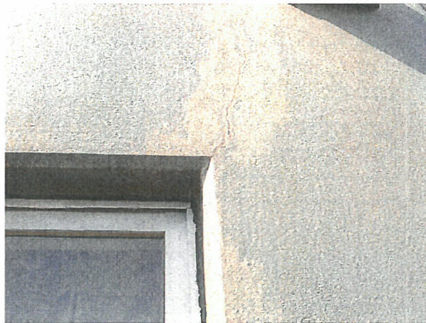
③ 窓サッシの上部角に クラックあり
