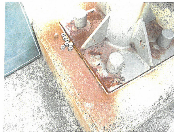
③ 外灯の足元ベースプレートに錆あり
