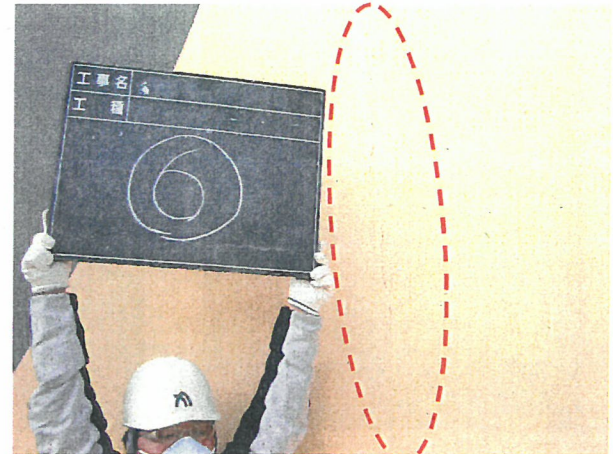
⑥ 外壁にクラックあり
