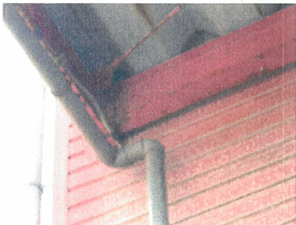
① 庇・鉄骨に錆あり
