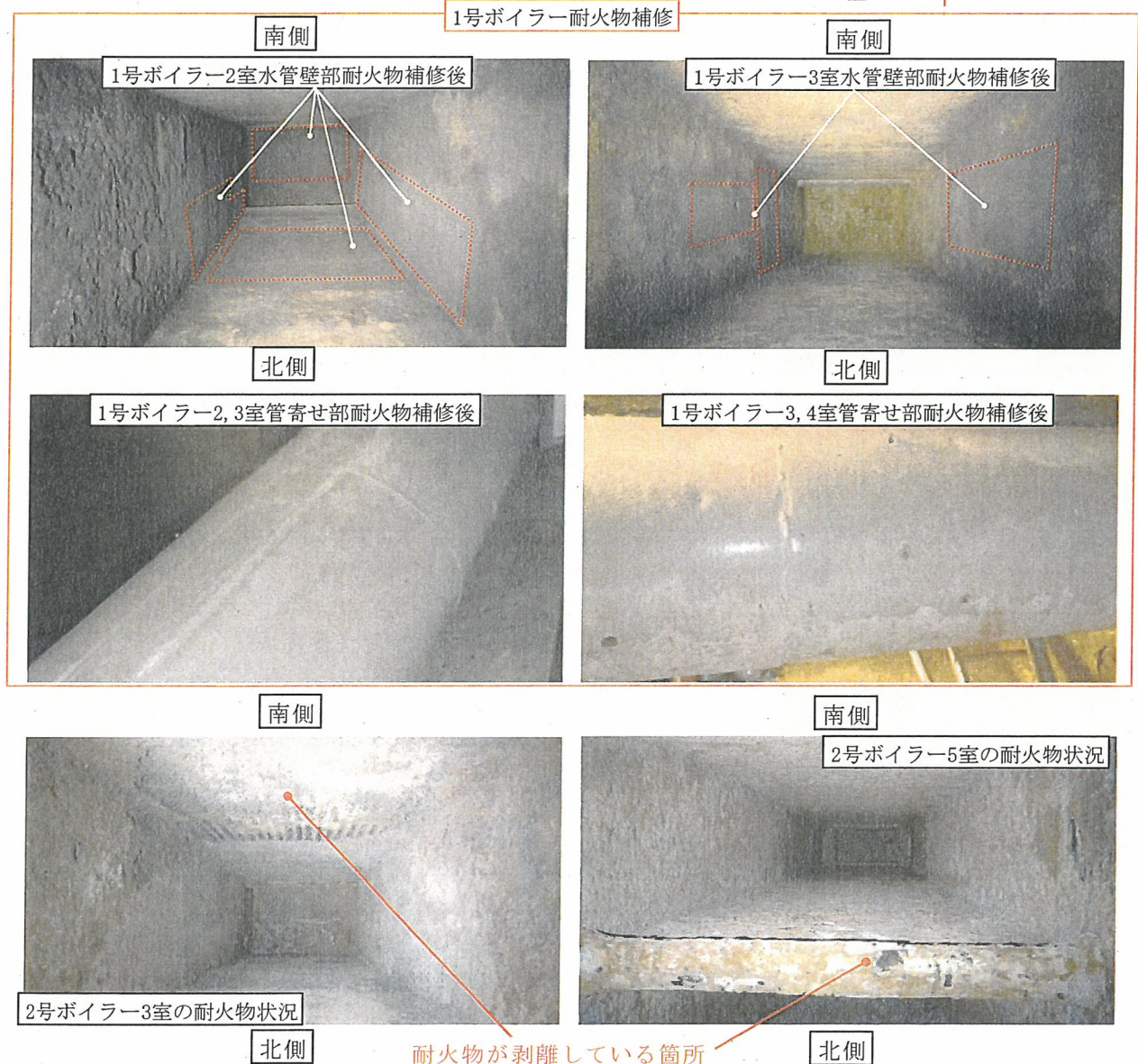
図 2.6 1,2 号ボイラー2～4 室の耐火物状況
