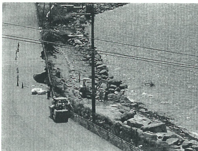
西海岸道路陥没状況 及び沈砂池1放流口の復旧状況(8月31日)
