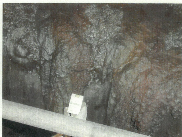
写真4 スラグポート (1号炉)
