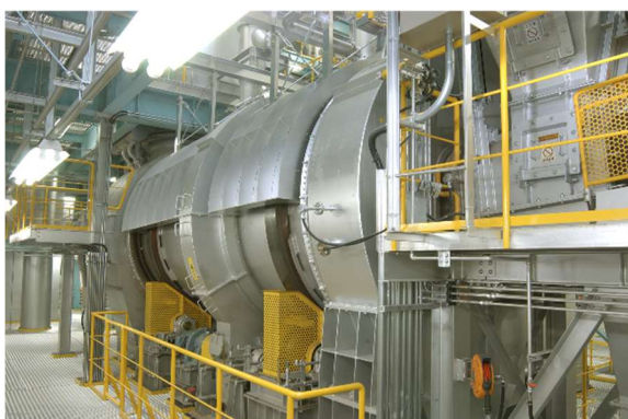
写真 3－1－5－3－2 ロータリーキルン炉
