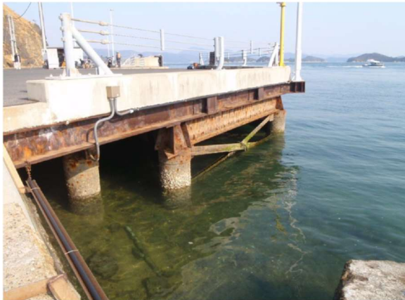
写真3-1-4-2-5 鋼材の状況（直島専用棧橋）
