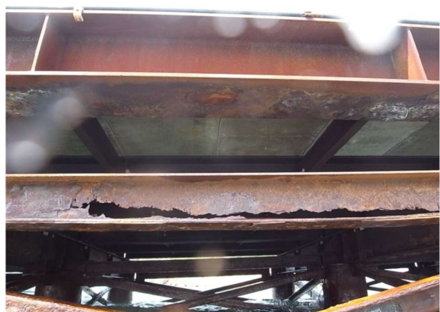
写真3-1-4-2-4 破口したH鋼材（豊島専用棧橋）
