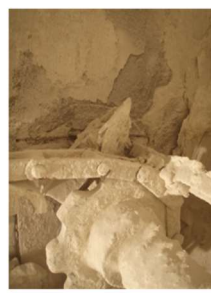
外れたエレベーションガイド が噛み込んでいた箇所
