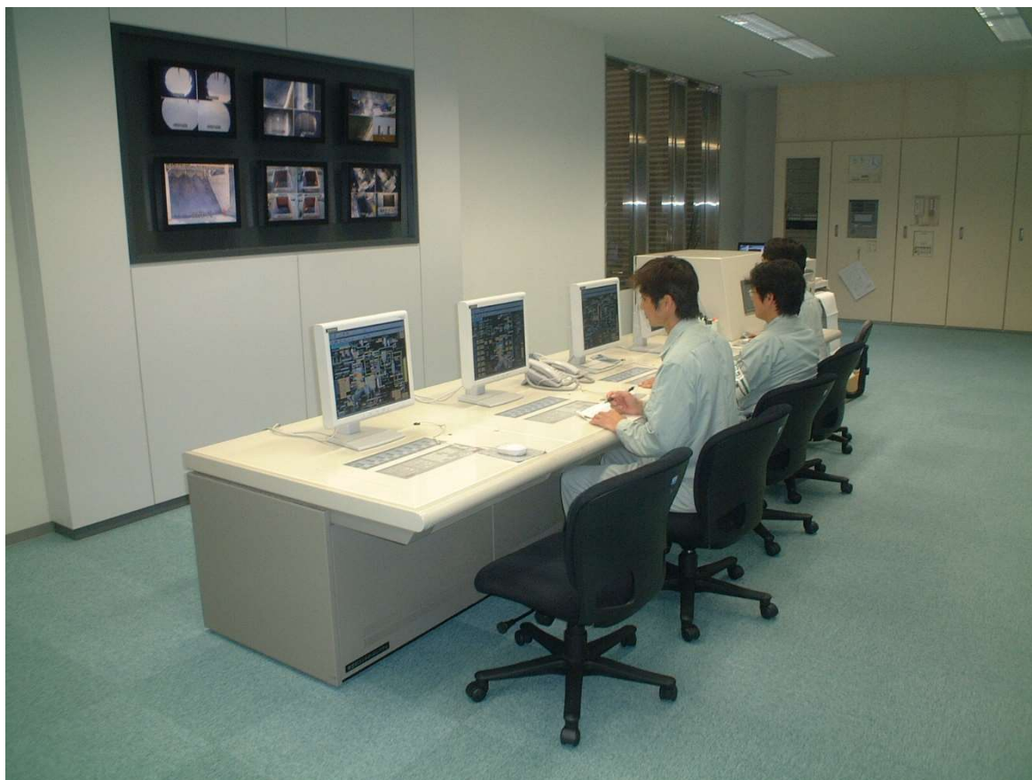
写真 10－5－31 中間処理施設 中央制御室
