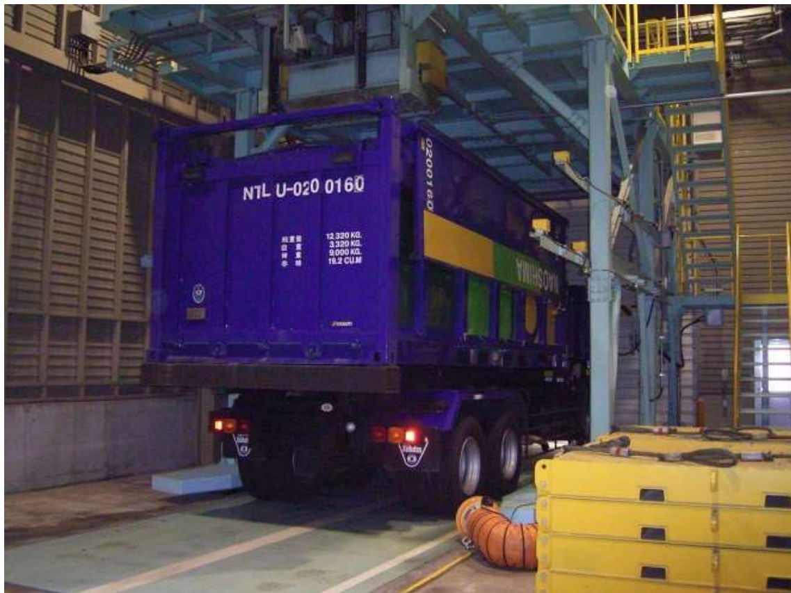
写真 10－5－21 中間保管・梱包施設 積込室
