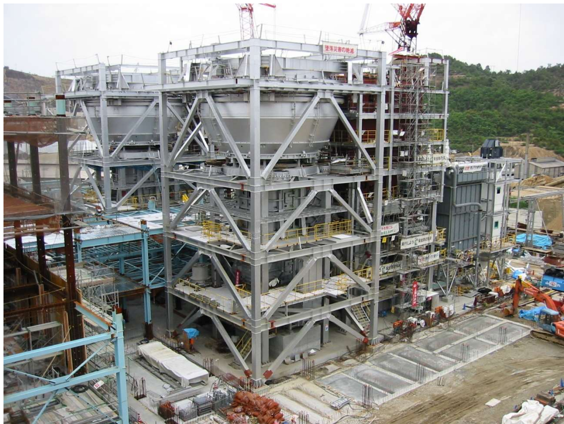
写真 10-5-29 中間処理施設 溶融炉
