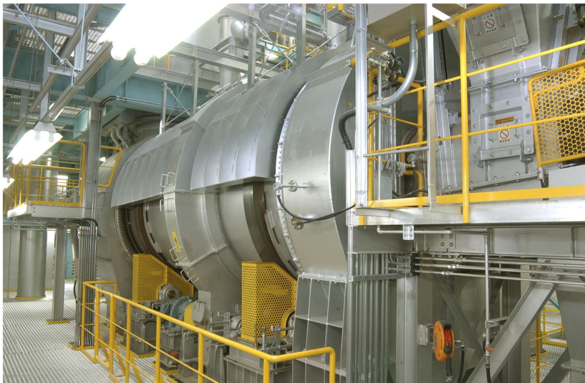
写真 10－5－30 中間処理施設 ロータリーキルン炉
