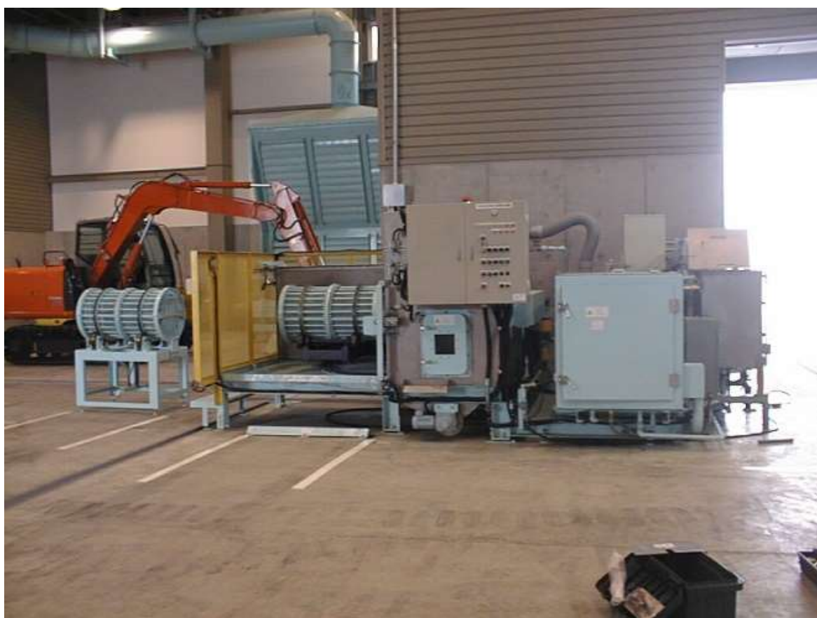
写真 10－5－19 特殊前処理物処理施設 洗浄機
