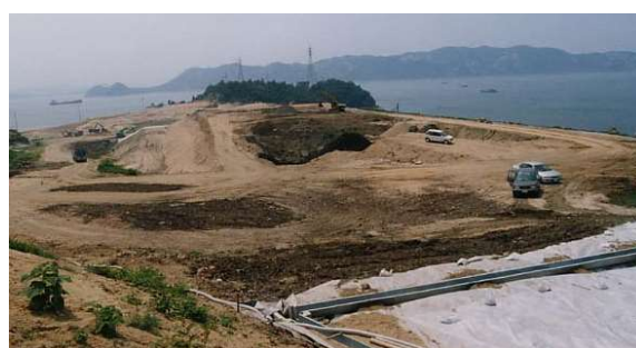
写真 2-2-3-2-1 廃棄物の移動等の状況
