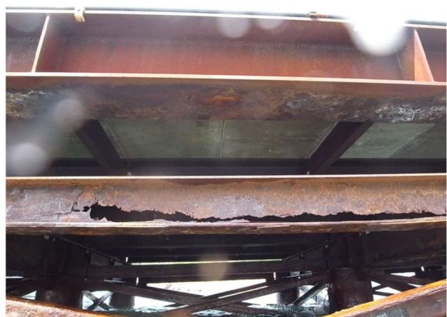
写真3-1-4-4-3 破口したH鋼材（豊島専用棧橋）
