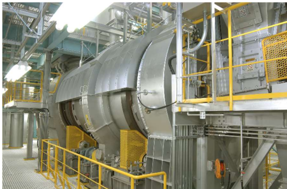
写真 3-1-5-3 ロータリーキルン炉
