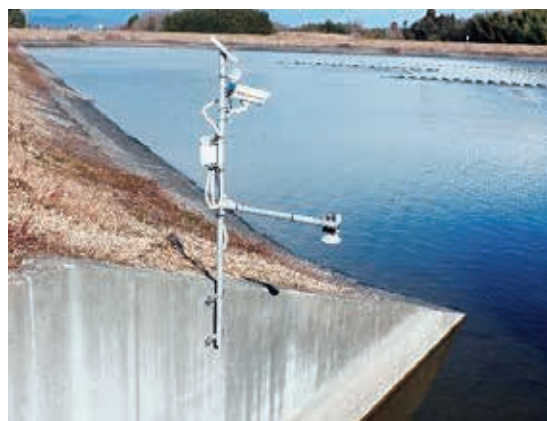
ため池水位計・監視カメラ （高松市 松尾池）
