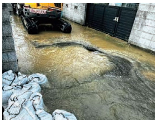
農業水利施設の長寿命化 (パイプラインの破損)
