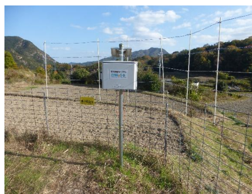
電気柵監視システム
