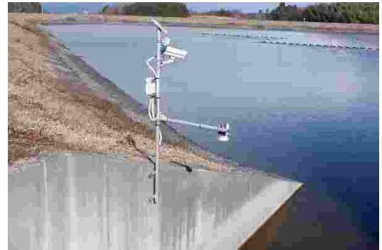
ため池水位計・監視カメラ（高松市 松尾池）
