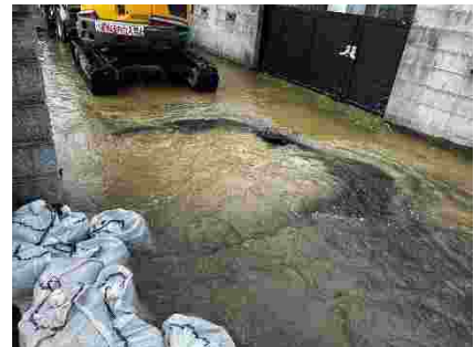
農業水利施設の長寿命化（パイプラインの破損）
