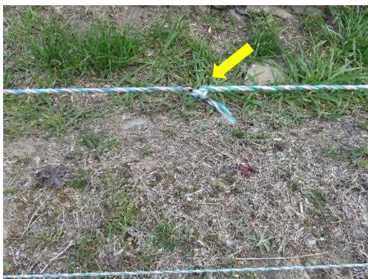
柵線の結び目から火花が出て焦げている
