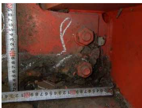
【鋼橋（主桁端部の腐食）】
