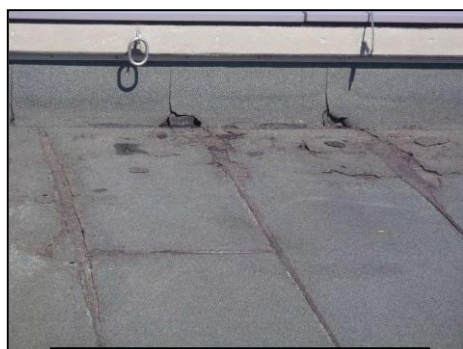
屋上防水層の浮き・剥がれ
