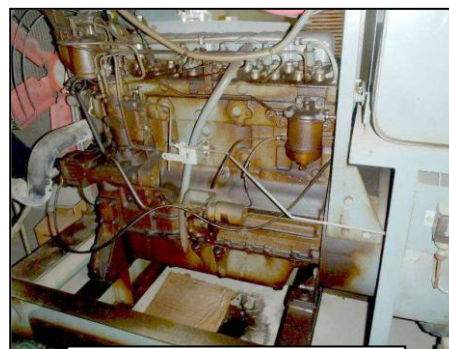
発電設備の錆、油漏れ
