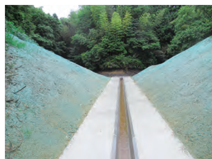
防災上放置できないため池の貯水機能廃止 上：対策前、下：対策後
