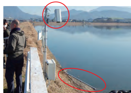
水圧式水位計と監視カメラ
