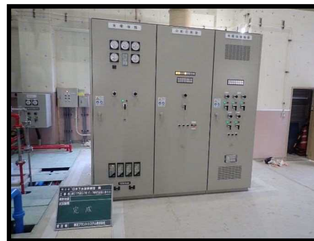
第1ポンプ場電気設備工事(完成)
