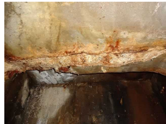
放流渠破損状況
