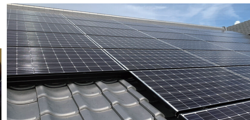
▲住宅用太陽光発電システム
