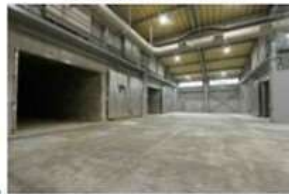
④ 発酵・乾燥 (バイオトンネル)
