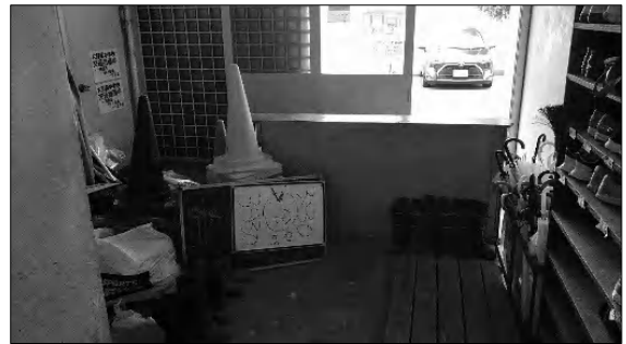
【1F 避難経路が下駄箱で遮断された様子】
