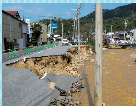
平成16年の台風23号により被害を 受けた津田川の様子。
