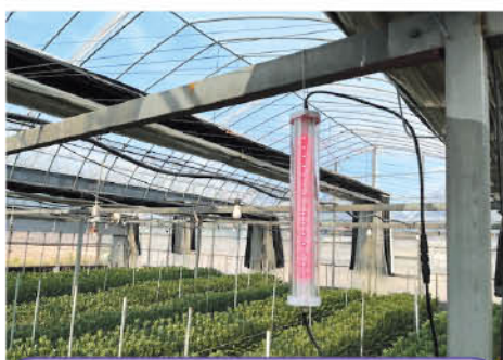
施設内の設置は吊り下げ方式
