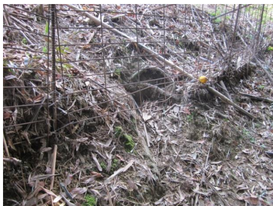
写真2 侵入防止柵の状況（補修前）
