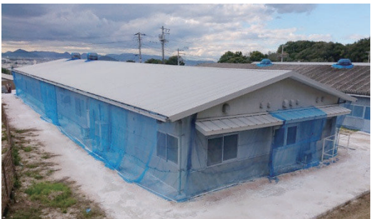
防鳥ネットの設置
