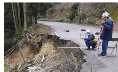
危険箇所での被災状況調査
