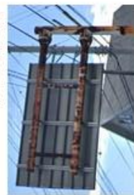
標識の損傷状況
