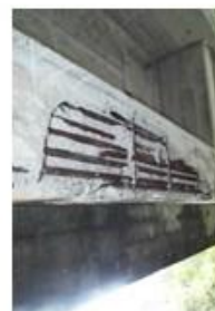
橋梁の損傷状況
