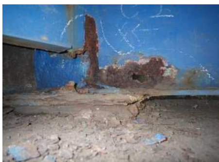
【鋼橋（主桁端部の腐食）】
